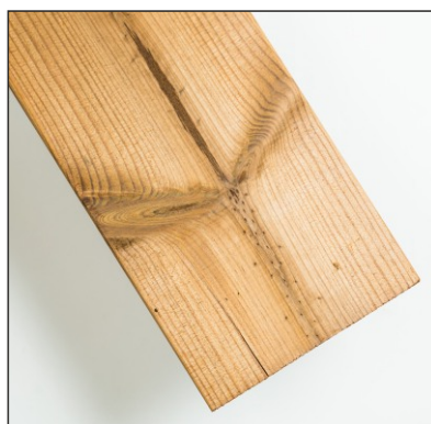
Trhliny na koncích prken jsou povoleny
