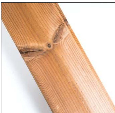
Praskliny v sucích jsou povoleny
