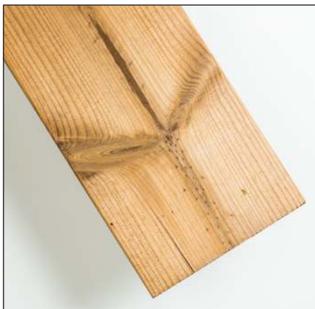
Trhliny na koncích prken jsou povoleny
